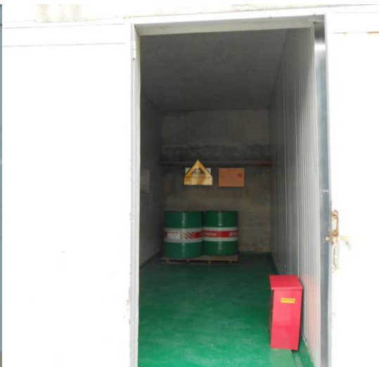
图4-6-5 危险废物库（内部）
