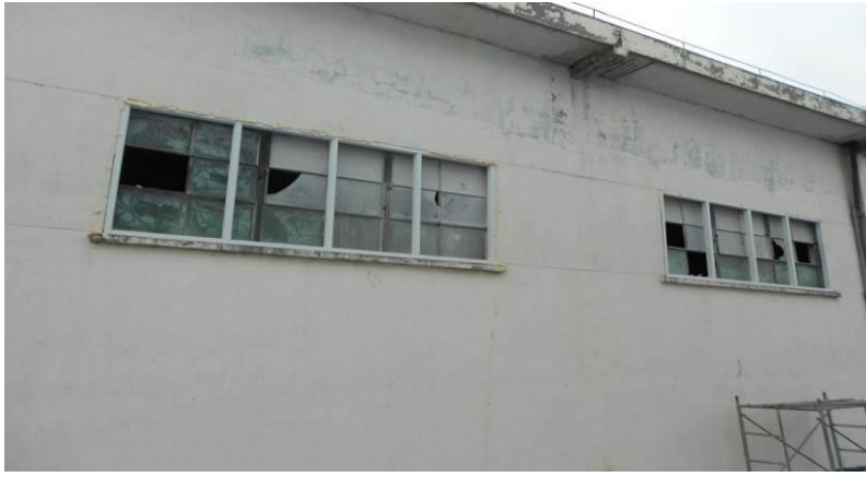
图 4-2-6 车间一炮楼玻璃窗（治理前）
