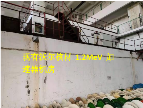
图 8-3 东侧沃尔核材加速器机房
